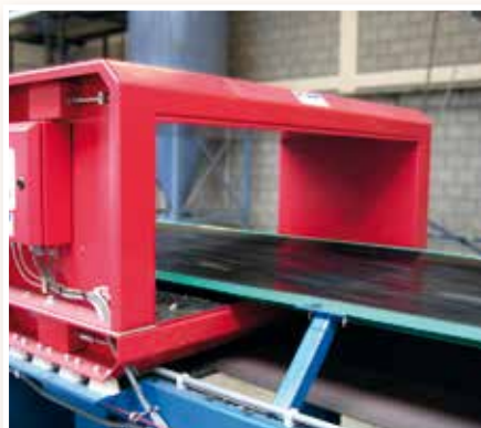
Установка металлоискателей с четко видимой „зоной, свободной от металлов“
