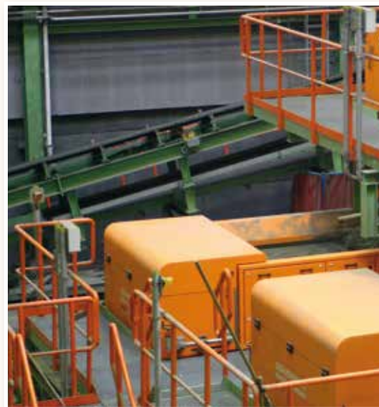
Три сепаратора цветных металлов типа NF1500 на вторичной переработке шлака на мусоросжигательном заводе
